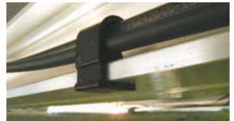
Kabelführung bzw. Kabelkanal
