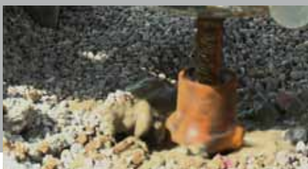
Austritt von Zementmörtel durch Kreuzbohrkrone
